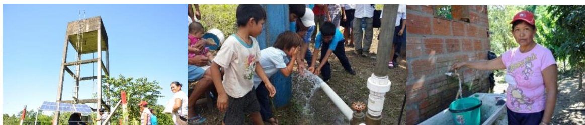
Foto: Tanque de almacenamiento de agua con panel fotovoltaico (izquierda), extracción de agua para descarga y limpieza del tanque (centro) red de distribución de agua familias a piletas (derecha)
