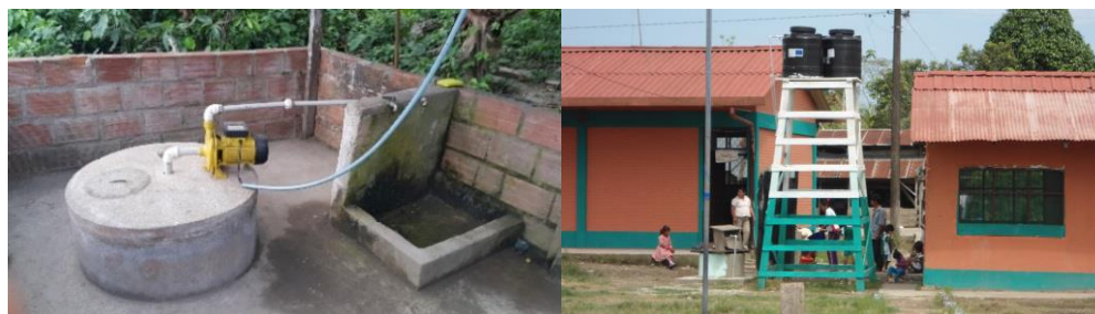
Foto: Pozo seguro y sellado con bomba eléctrica (izquierda. UE Villa Jordán) y tanques elevados de almacenamiento de agua (Derecha: Puerto san Francisco)
